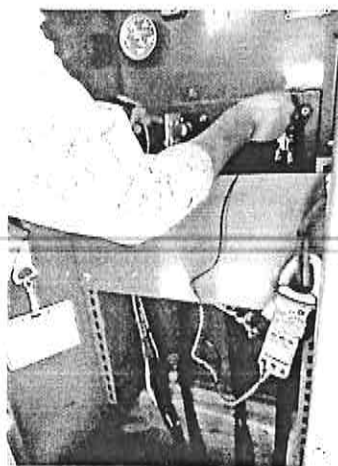
Figura 2 La imagen muestra las mediciones de voltaje realizadas en el secundario del transformador Pad Mouted de la planta piloto. Las mediciones fueron realizadas junto con personal de mantenimiento del centro regional
